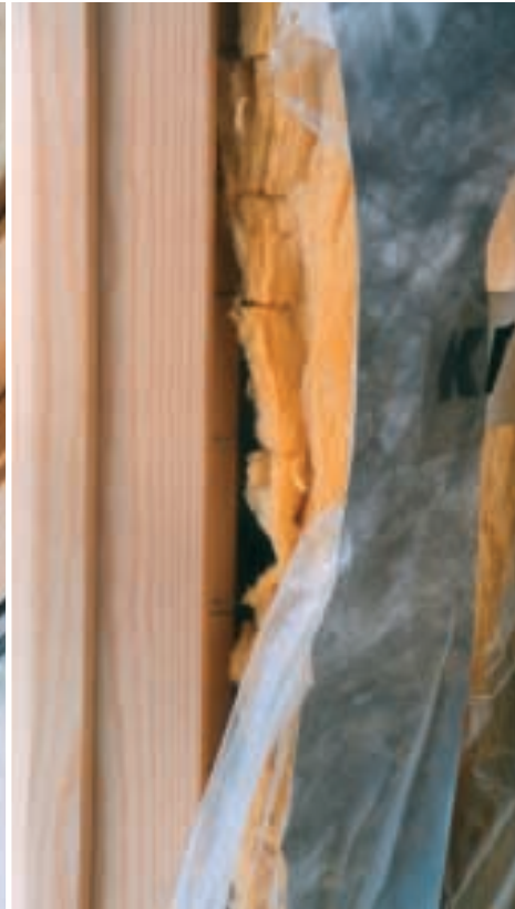
Mangelhafte Ausführung der →Luftdichtungsschicht. Die Folie hat sich vom Rahmen gelöst.
